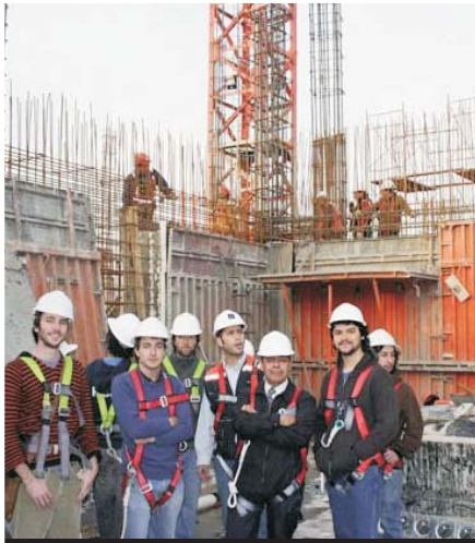
Taller de Hormigón
